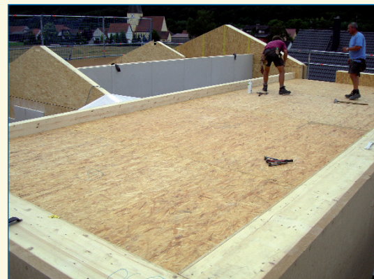
In nur 17 Tagen wurden alle Wand-, Decken und Dachelemente produziert – das längste misst 11,55 m
